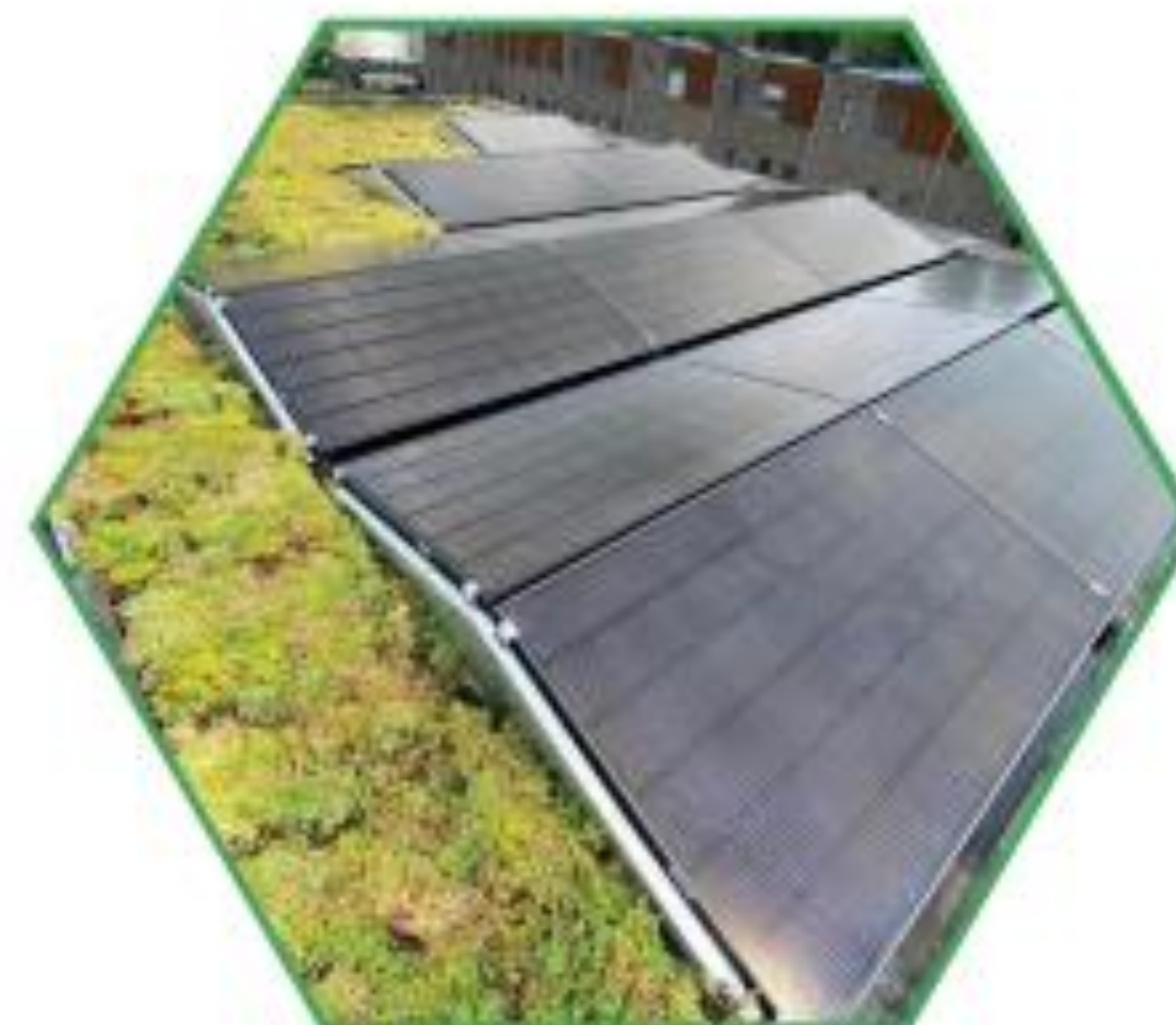
duurzame energieopwekking/buffering van energie
